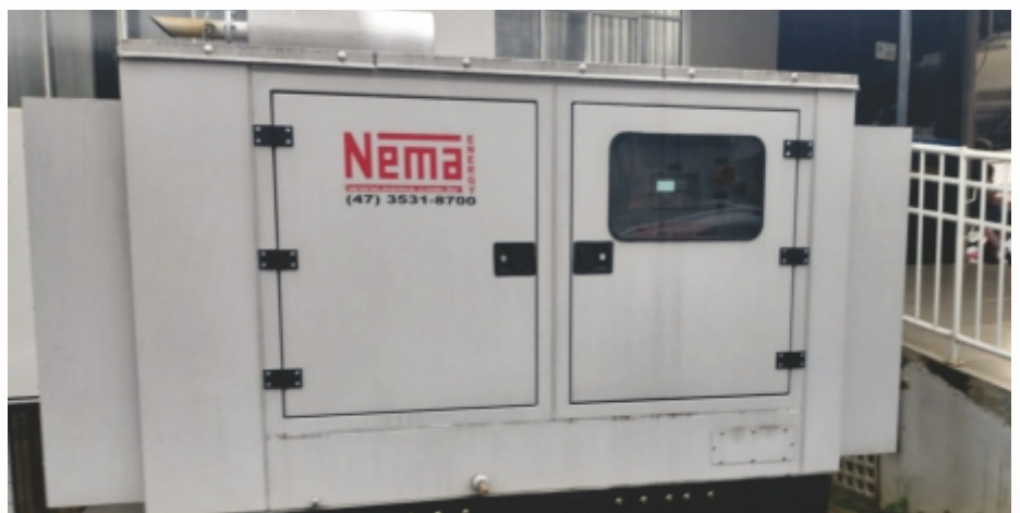
Aquisição e instalação de gerador de energia para a Unidade Básica de Saúde.
